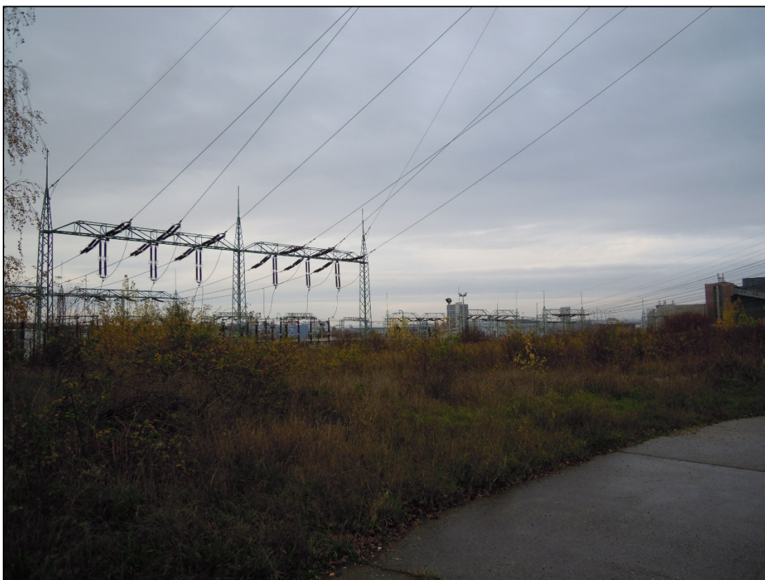
Obr. 1 Místo zaústění vedení 400 kV do TR Malešice
